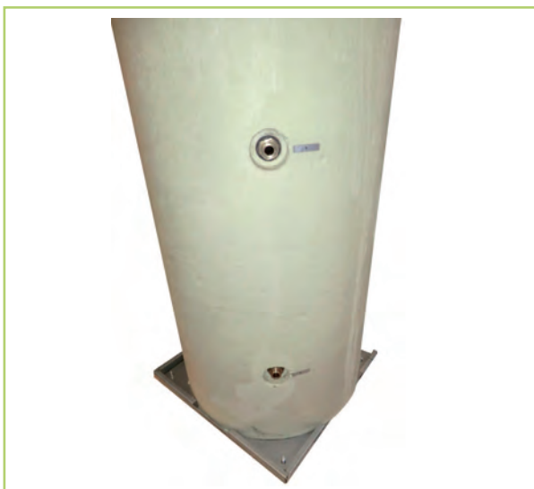
Abb. 6: Nummerierte Anschlüsse am Speicher
