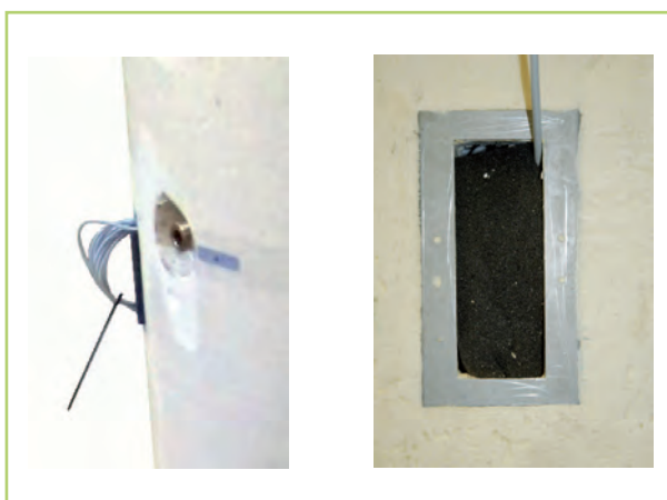
Abb. 8: Installation des Tauchfühlers
